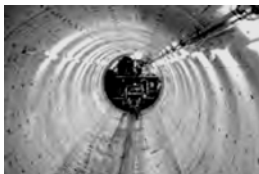
پوشش داخلی تونل به وسیله قطعات بتن
